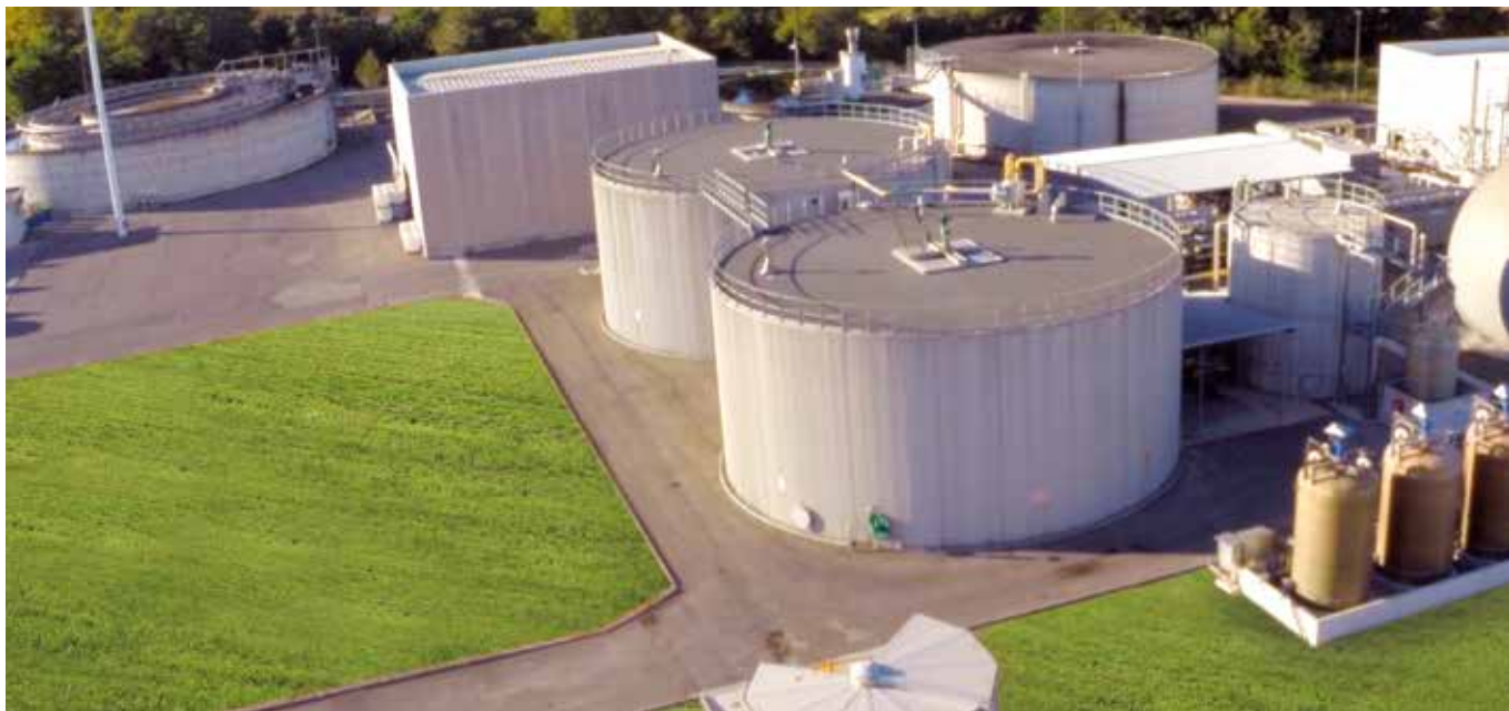
Impianto di Biogas, Ospedaletto Lodigiano (LO)
